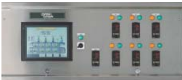
Instrumentpanel med PLC-styrning.
